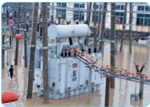
图4.1.1 电力设备被损坏
